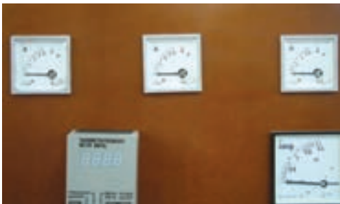
شکل ۱۱-۶- آمپرمترهای اندازه‌گیری جریان فازها
