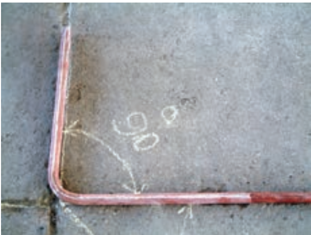
شکل ۳-۵۷- لوله‌ی خم کاری شده
