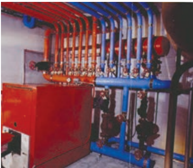
شکل ۴-۱۲- لوله‌های فولادی درزدار سیاه عایق‌بچی شده در حرارت مرکزی
