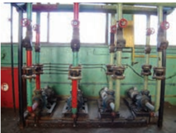
شکل ۳-۵- کاربرد لوله درزدار در لوله‌کشی شوفاز
