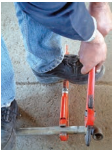
شکل ۱۲۵-۵- نحوه‌ی سفت کردن فیتینگ به لوله به وسیله‌ی دو عدد آچار لوله‌گیر
