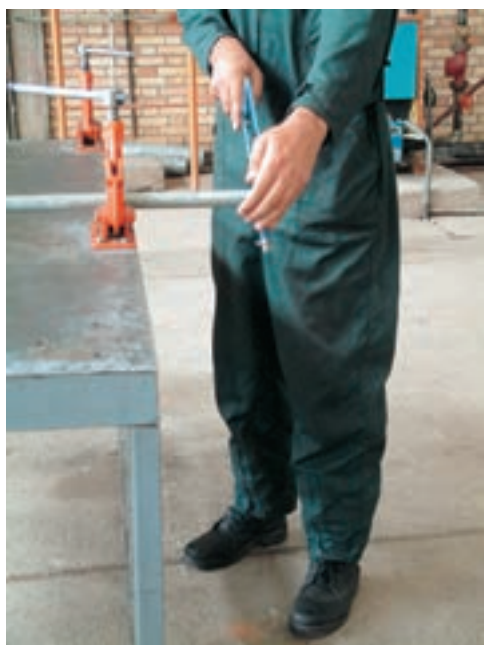
شکل ۵-۹۵- فاصله‌ی محل برش از لبه‌ی گیره‌ی لوله بیش از حد مجاز است.
