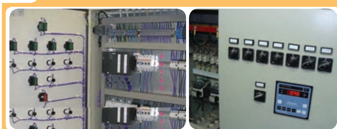
تابلوهای برق صنعتی موجود در کارگاه‌ها
