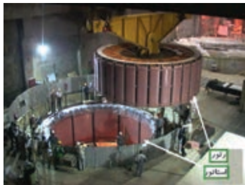
شکل ۸- رتور ژنراتور نیروگاه آبی سد شهید عباسپور در حال
