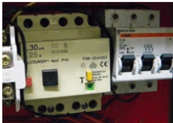
شکل ۱-۵- فیوز حفاظتی نصب شده در کارگاه
