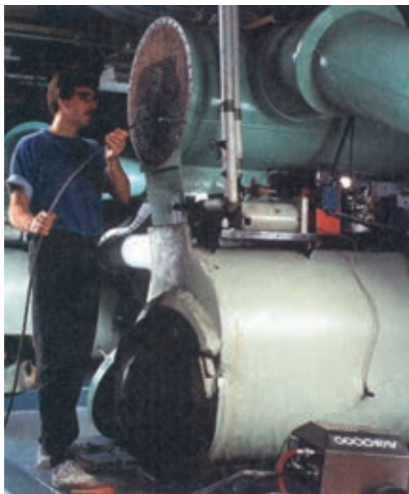
شکل ۶-۴ الف) کندانسر پوسته و کوئل ب) کندانسر پوسته و لوله ج) تمیز کردن لوله‌های کندانسر پوسته و لوله د) برس مخصوص تمیز کردن لوله‌های کندانسر
