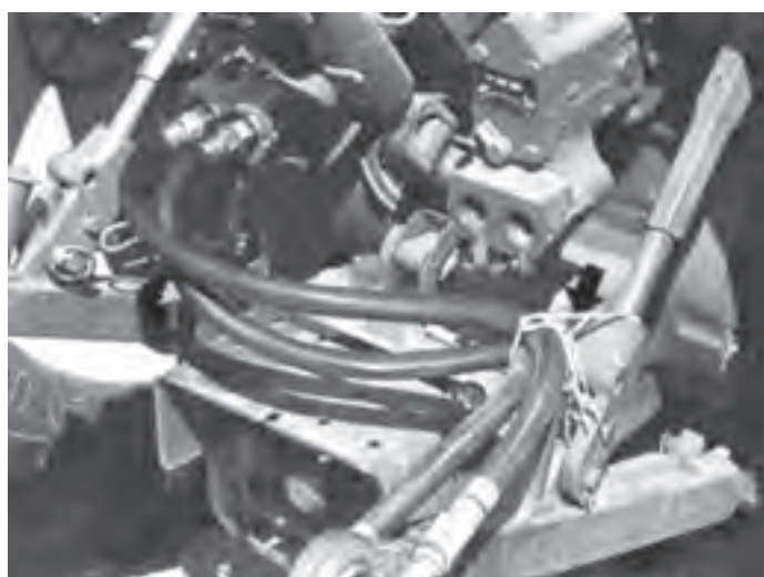
شکل ۱۳-۶- مهار نامناسب شیلنگ‌های هیدرولیک
