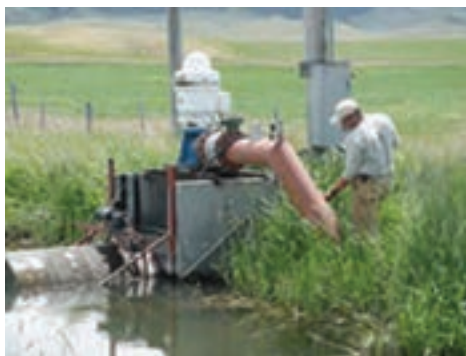
شکل ۱-۱- پمپ در حال انتقال آب از کانال
