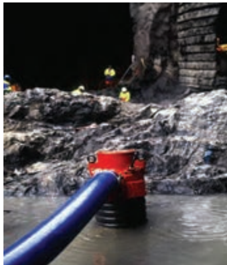
شکل ۱-۳- پمپ زهکش در حال کار
