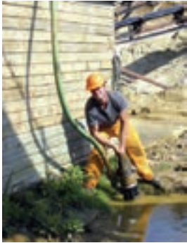
شکل ۲-۳۲- کاربرد پمپ کفکش
