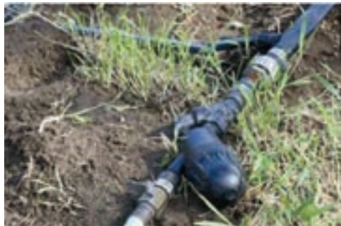
الف) فیلتر در مسیر شبکه آبیاری
