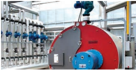
دیگ آب گرم لوله‌های انتقال آب گرم و پمپ‌ها (در یک موتورخانه سیستم گرمایش مرکزی)
