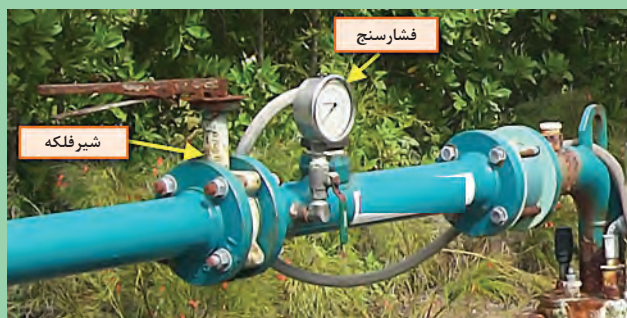
شکل ۱۳- محل شیرفلکه و فشارسنج روی لوله رانش
