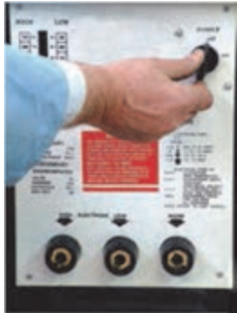
شکل ۵- نمایی از ترانسفورماتور
