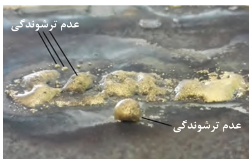
شکل ۴-۲۱- عدم ترشوندگی سطح فلز را به دلیل سرد بودن درز اتصال، نشان می‌دهد.
