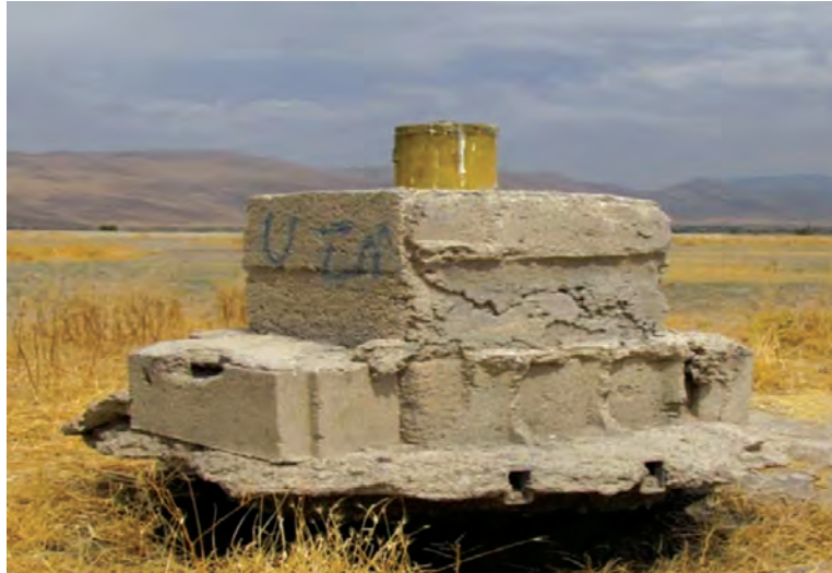
تصویر ۸-۴- پدیده فرونشست زمین (منطقه خانمیرزا)
