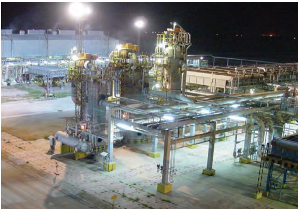
شکل ۳۲-۵- کارخانه گاز و گاز مایع شماره ۹۰۰- اهواز
