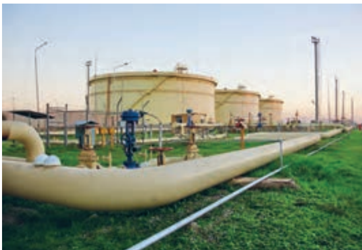
شکل ۲۱- نمایی از خطوط انتقال سوخت
