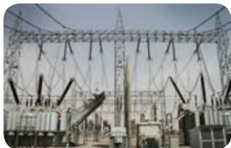
شکل ۱۷- پست انتقال برق
