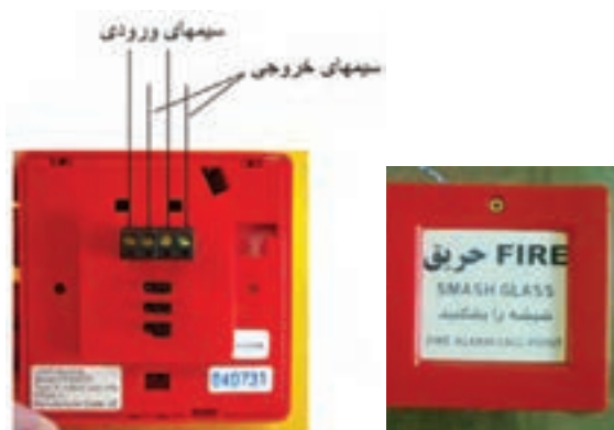
شکل ۱۰- شستی اعلام حریق با راهنمای فارسی
