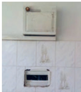
شکل ۲- نصب تابلو فیوز روکار با نوع آسیب دیده توکار
