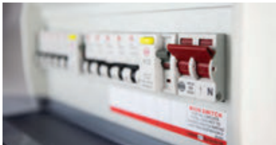
شکل ۷۹- تابلو توزیع برق واحد مسکونی
