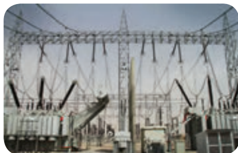
شکل ۱۷- پست انتقال برق
