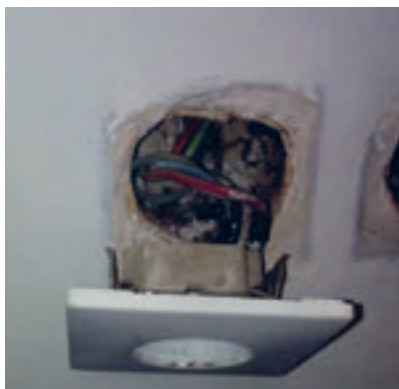
شکل ۳- قاب جداشده پریز از دیوار
