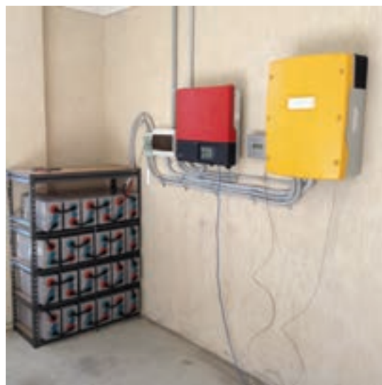
شکل ۶۱- اتصالات سیستم فتوولتائیک
