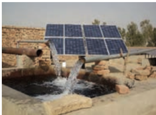
تأمین برق چاه آب
