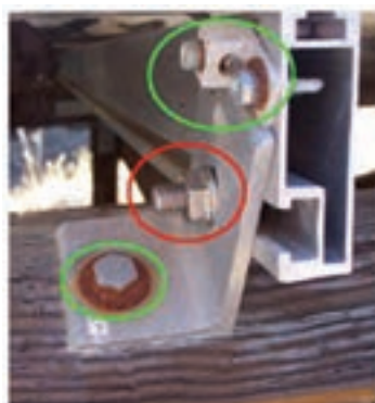
شکل ۵۶- پیچ متصل به سازه فرسوده شده است
