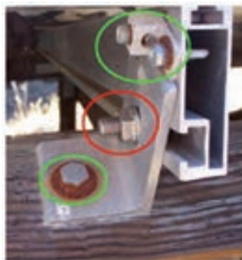
شکل ۵۶- پیچ متصل به سازه فرسوده شده است
