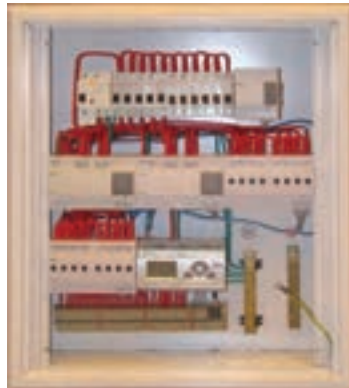
شکل ۵۳- دو نمونه تابلوی توزیع برق (DP)
