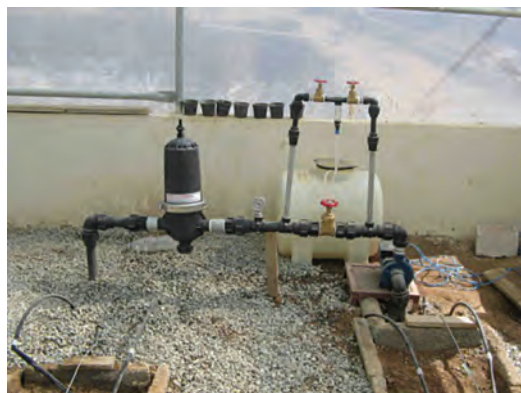
شکل ۱۴- نمونه‌ای از سیستم آبیاری گلخانه
