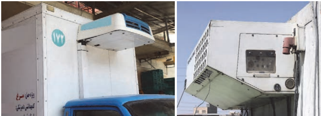
شکل ۲۱- تجهیزات سرمایشی نصب شده بر روی وسیله‌نقلیه
