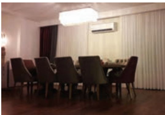
شکل ۹۲-۲- ظاهر شدن دستگاه تهویه مطبوع بر روی دیوار داخل اتاق
