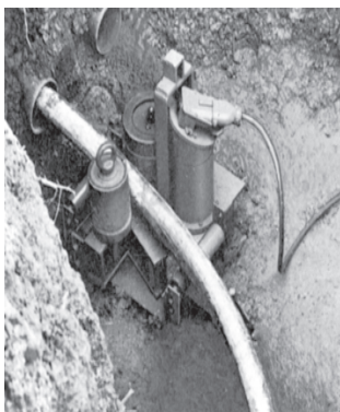
شکل ۵-۵۱- دستگاه کشش کابل
