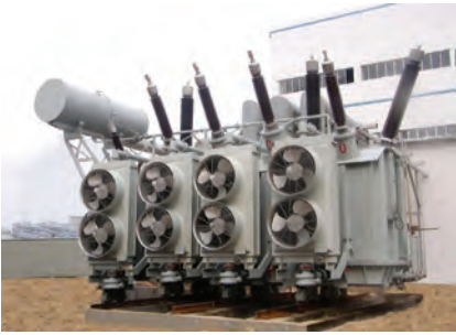
شکل (۳-۱) ترانسفورماتور خطوط انتقال
