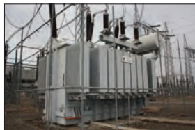
شکل ۱- تصویر ترانسفورماتور قدرت
