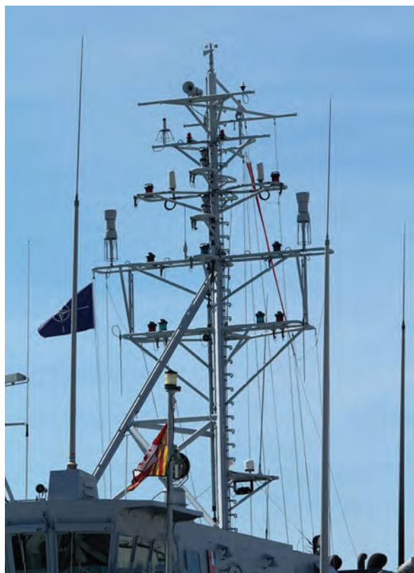
شکل ۳۲- محل نصب چراغ‌ها ناوبری
