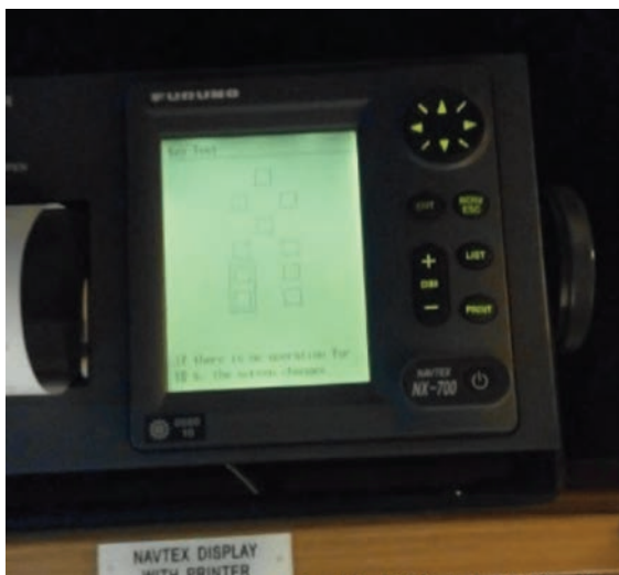
شکل ۴۳- آزمایش کلیدهای دستگاه NAVTEX
