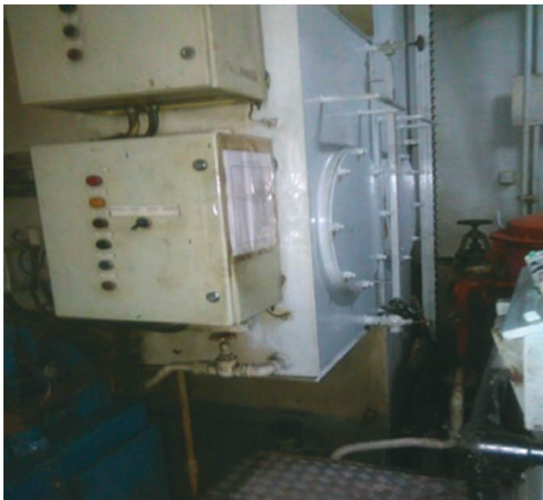
شکل ۲۳- مخزن سوخت روزانه یک شناور
