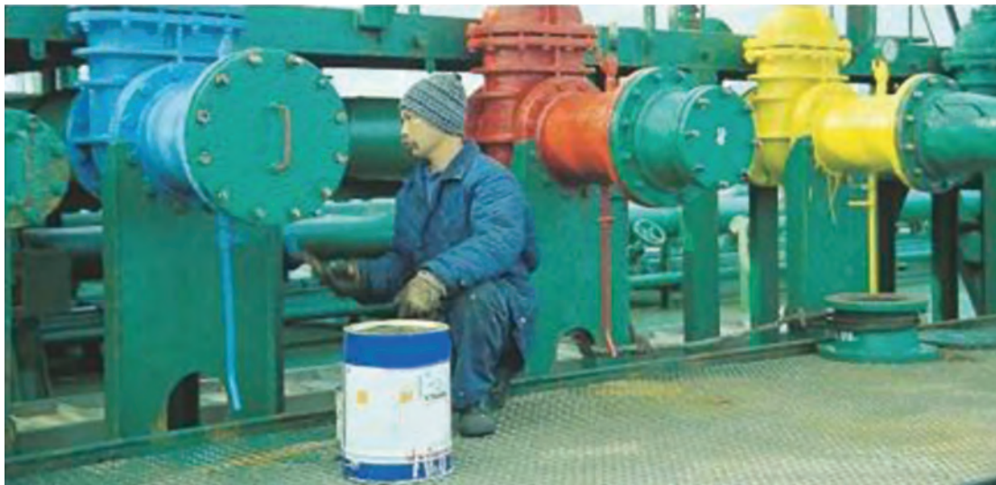
شکل ۵۵- رنگ آمیزی سامانه‌های لوله‌کشی بر روی عرشه
