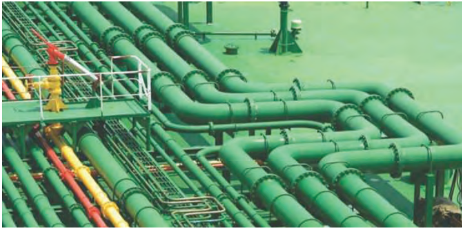
شکل ۲۹- سامانه لوله‌کشی روی عرشه یک نفتکش
