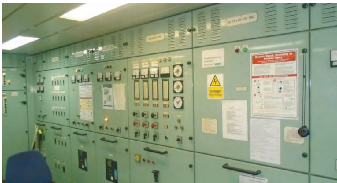
شکل ۲۳- تابلوی اصلی برق شناور
