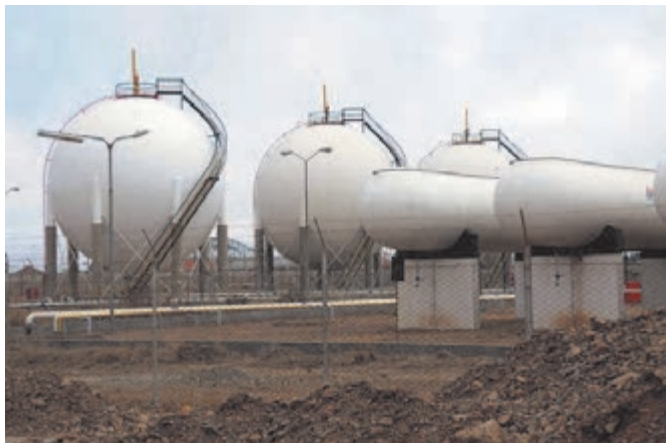
شکل ۴-۱۵ مخازن تحت فشار
