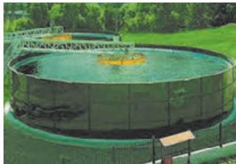
شکل ۱۳-۴- مخزن ذخیره‌سازی بدون سقف
