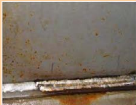
شکل ۴-۶- چگونگی سطوح خورده شده
