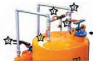
۲۰- شیرهای برگشت (By pass)، ۳ و ۴- شیرهای ورودی و خروجی مخزن ۵- شیر فلکه روی لوله اصلی
