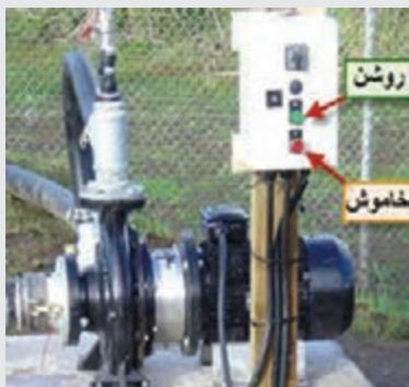
شکل ۲۰- کلیدهای کنترل روی تابلو
