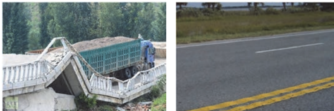
شکل ۱۳- تخریب رویه روسازی و ابنیه فنی
