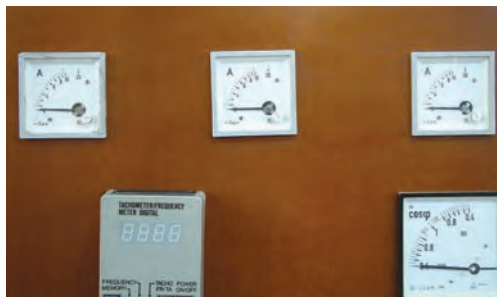
شکل ۱۱-۶- آمپرمترهای اندازه‌گیری جریان فازها
