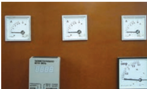
شکل ۱۱-۶- آمپرمترهای اندازه‌گیری جریان فازها
