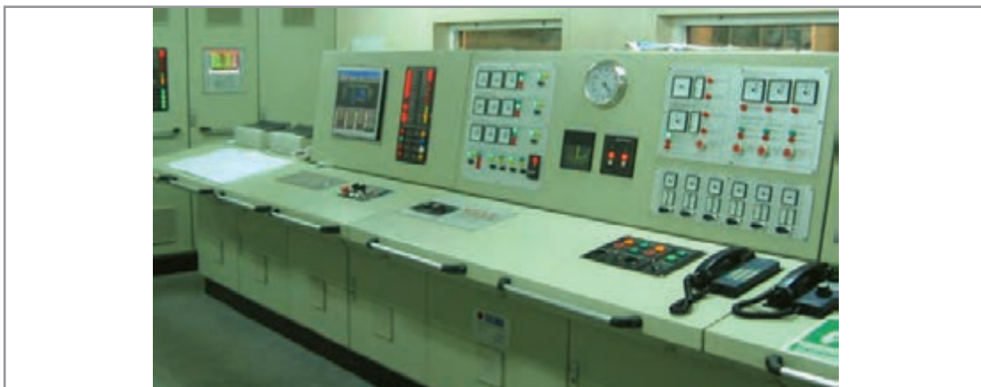
شکل ۴۰ - سامانه هشدار اتاق کنترل موتورخانه
