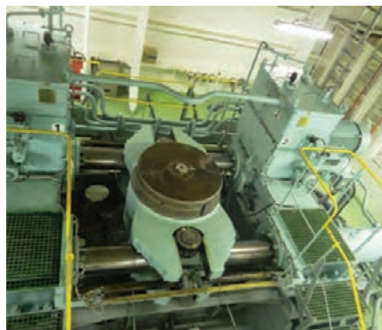
شکل ۳۷- تجهیزات اتاق سکان
