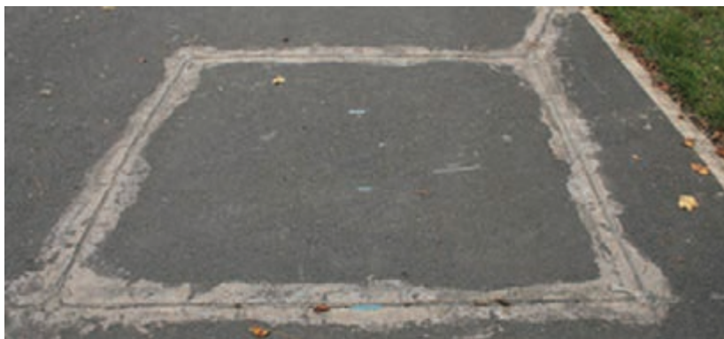
شکل ۲- نمونه نصب شده از حلقه‌های مغناطیسی
