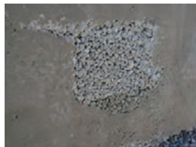
افزایش فضای خالی بتن در اثر ویبره نکردن
