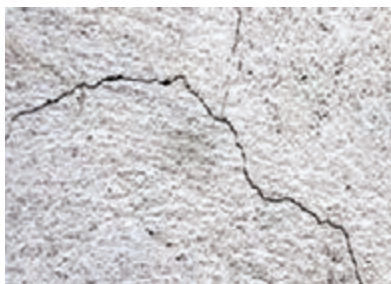
ترک خوردگی انقباضی بتن
