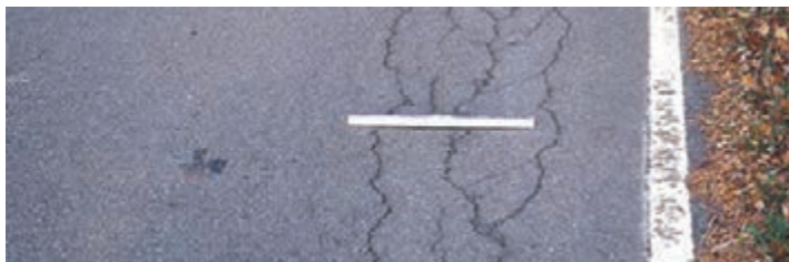
شکل ۳۷- ترک پوست سوسماری در سطح آسفالت
