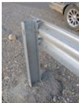
شکل ۶۳- اجرای پایه حفاظ به روش ناصحیح
