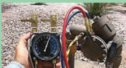
شکل ۱۷- تنظیم فشار شیر فشارشکن
