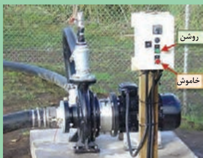
شکل ۱۴- کلیدهای کنترل روی تابلو
