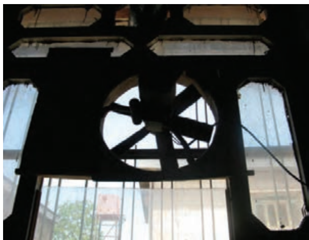
شکل ۳۸-۸- هواکش بزرگ در کارگاه.
