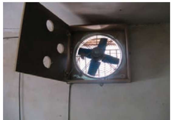
شکل ۴۷-۱۳- یک دستگاه تهویه در اتاق رنگ‌کاری.
