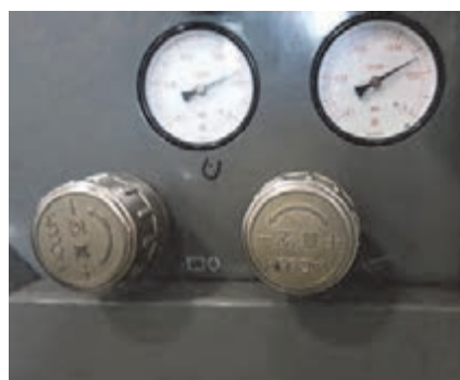
شکل ۴۲- شیر تنظیم مکش (شیر سمت چپ)
