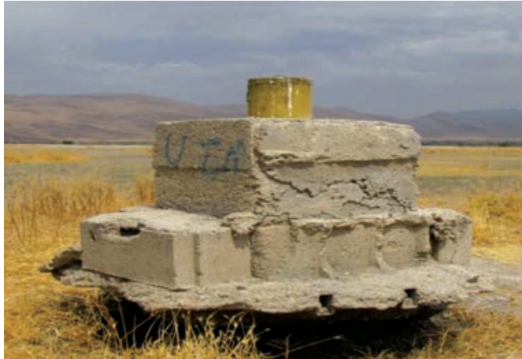
تصویر ۸-۴- پدیده فرونشست زمین (منطقه خانمیرزا)
