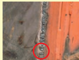
عدم جوش پیوسته - لوچه
