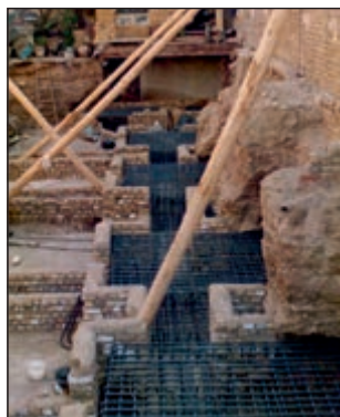
شکل ۹۰-۱ مهاربندی با شمع چوبی
