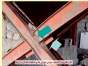
ضعیف بودن جوش و عدم اتصال مناسب
