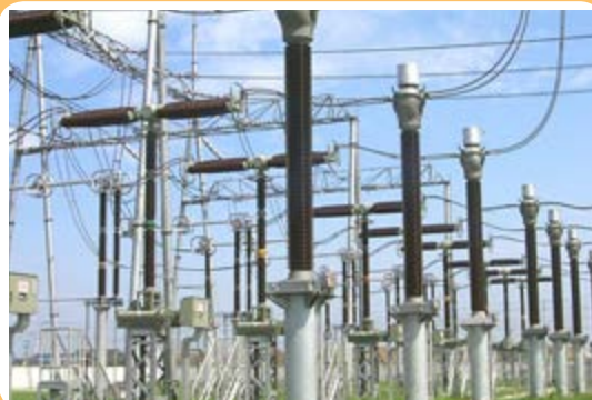
پست تقویت ولتاژ جریان برق
