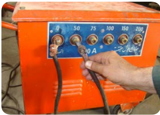
تنظیم آمپر در دستگاه ترانسفورماتور پله‌ای
