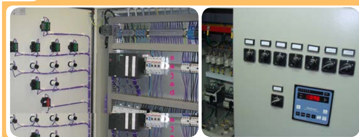
تابلوهای برق صنعتی موجود در کارگاه‌ها
